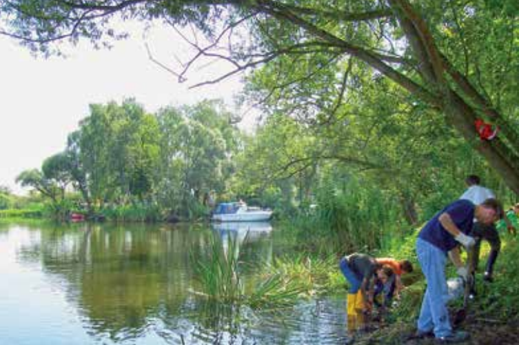
Die NAJU beim Entfernen von Uferdeckwerken. In den kommenden Jahren sollen 71 dieser Steinpackungen auf einer Länge von rund 30 Kilometern abgetragen werden.
